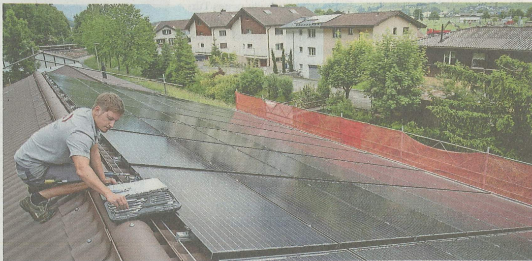
Andreas Rohrer von der Firma Odermatt + Sicher AG montiert die Solarpanels auf dem Dach des Pfadiheims.
